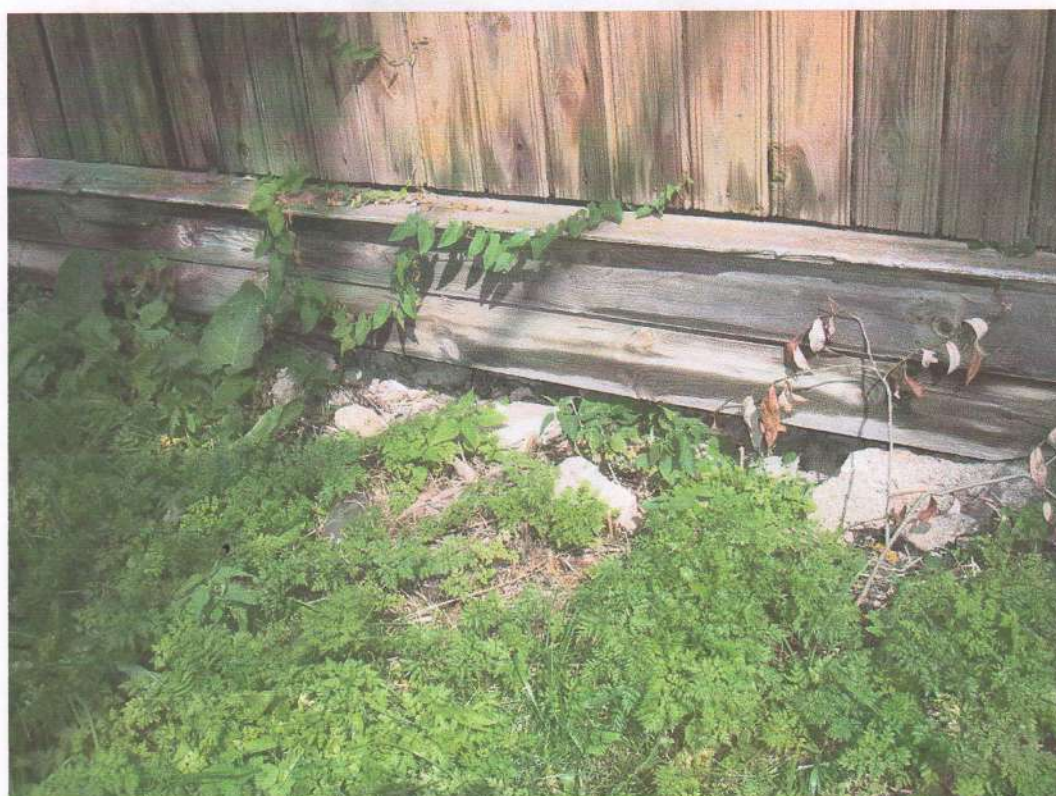
Фото №6. Состояние фундамента.
