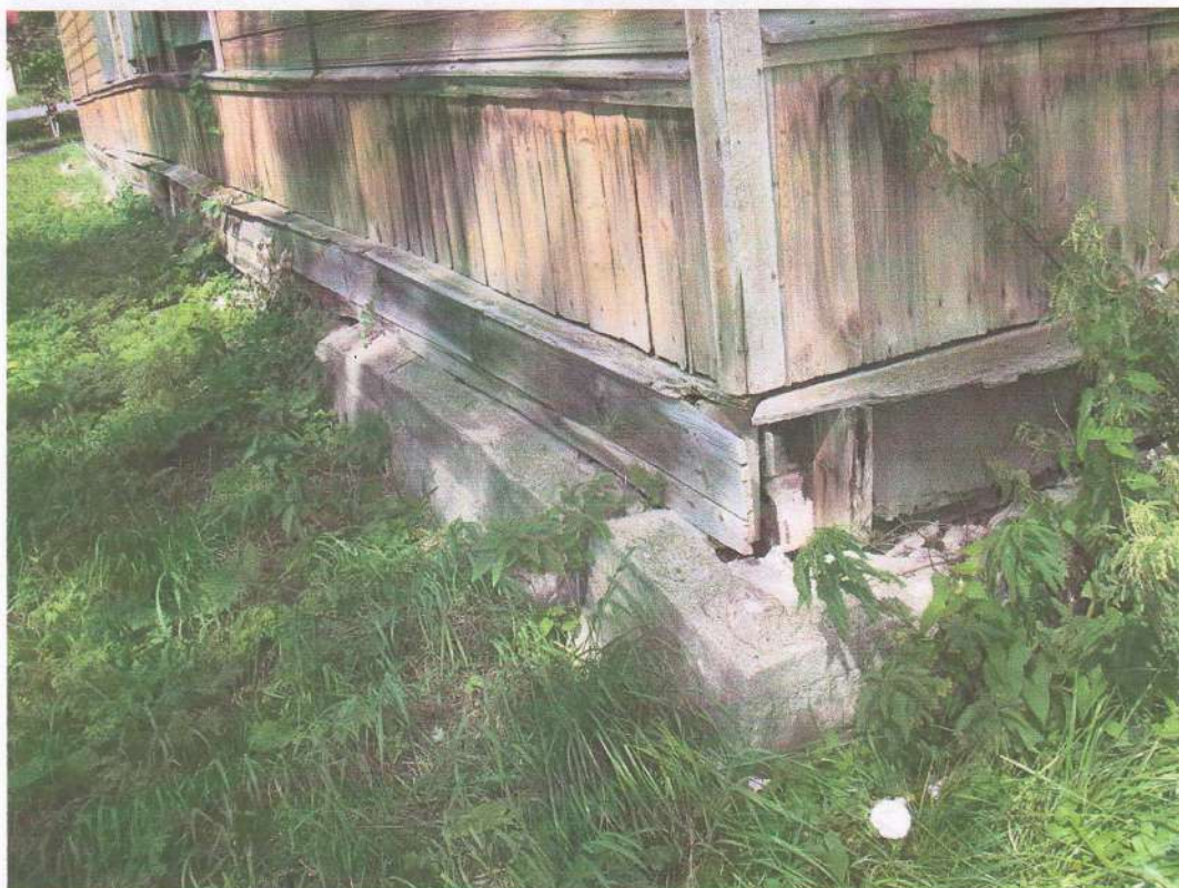
Фото №5. Состояние фундамента.
